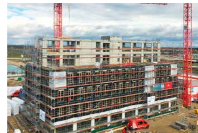
Das Wiener „HoHo“ weist ähnlich wie die Wildspitze einen Betonkern auf, um den mit Holz herumgebaut wird
