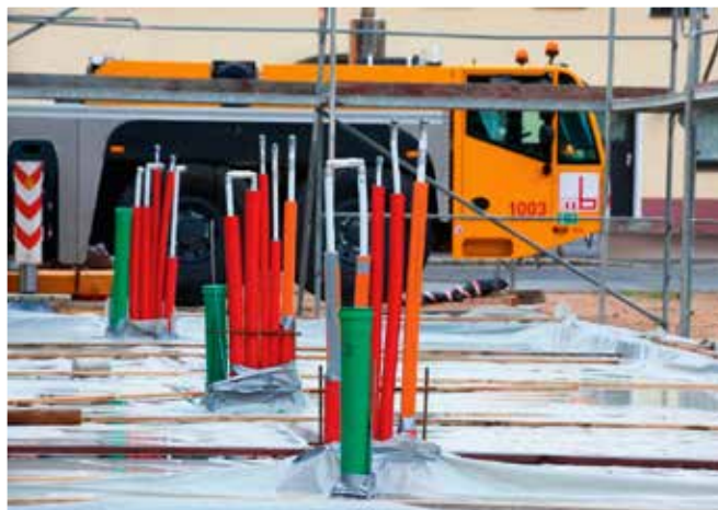
Fundament mit der nötigen Vorinstallation zum Anschluss der Maxmodule auf der Baustelle
