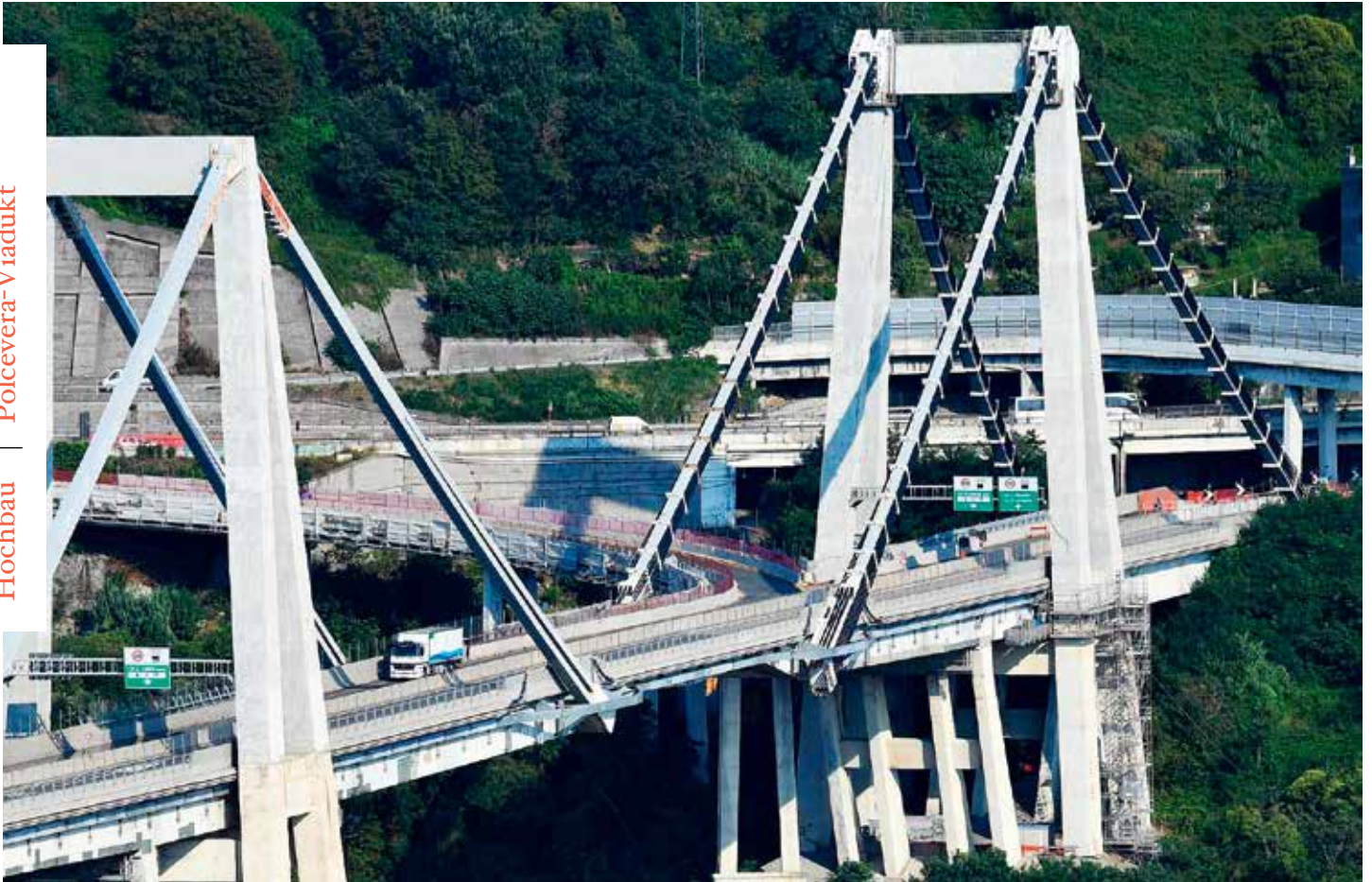
Rechts im Bild das östliche Brückenfeld mit an der Ummantelung der Schrägseile angebrachten zusätzlichen Trageilen
