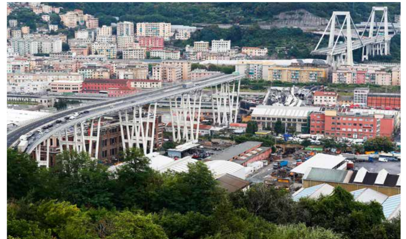
Das westliche Hauptfeld ist eingestürzt und riss bei der Havarie die benachbarten Einhängeträger mit in die Tiefe
