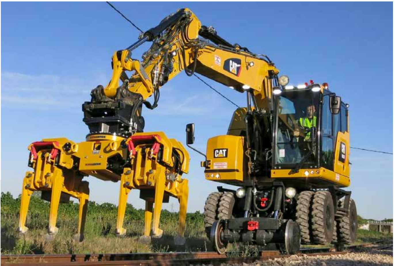
Große Übersicht bei der Arbeit (hier mit Schotterbettverdichter) verspricht die moderne Kabine des Zweiwegebaggers
