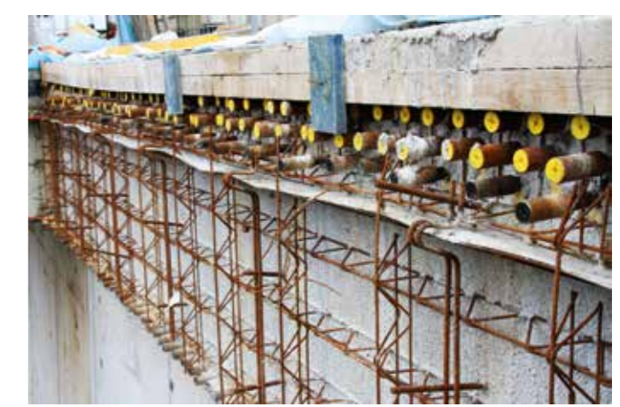
Hier kann sich das gegenüberliegende zweite Tunnelbauwerk für die Fahrbahn nach Norden nahtlos anschließen
