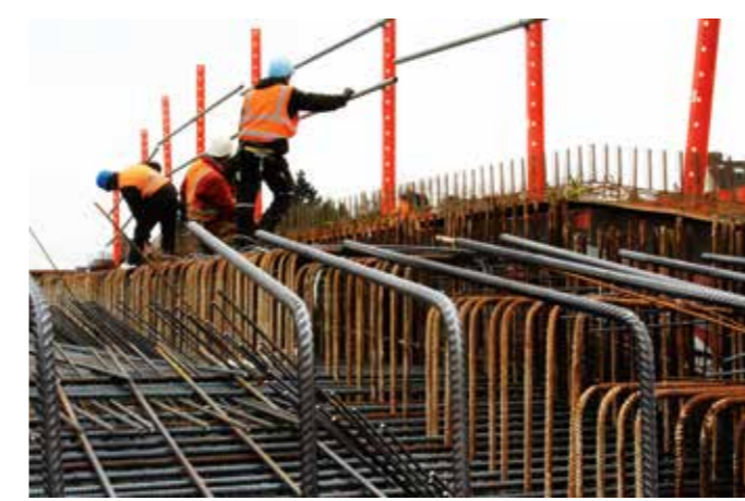
Enorm dicht gepackt: Bei einer derartigen Armierung hält die Tunneldecke auch größten Belastungen stand
