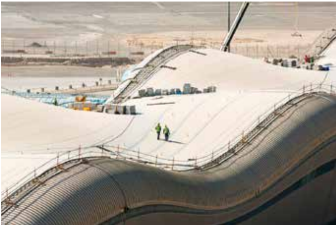
Die komplexe Form der Trakwerksteile unter der welligen Dachkonstruktion ist nur noch per BIM beherrschbar
