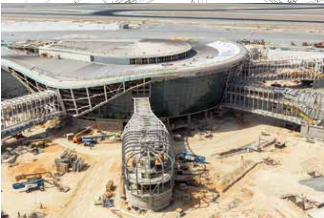
Die Tragwerkskonstruktion der Ausleger, an denen die Passagierbrücken verankert werden, und der ...
