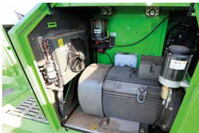
Angetrieben wird der Sennebogen 8100 EQ Balancer von diesem 110 kW starken Elektromotor
