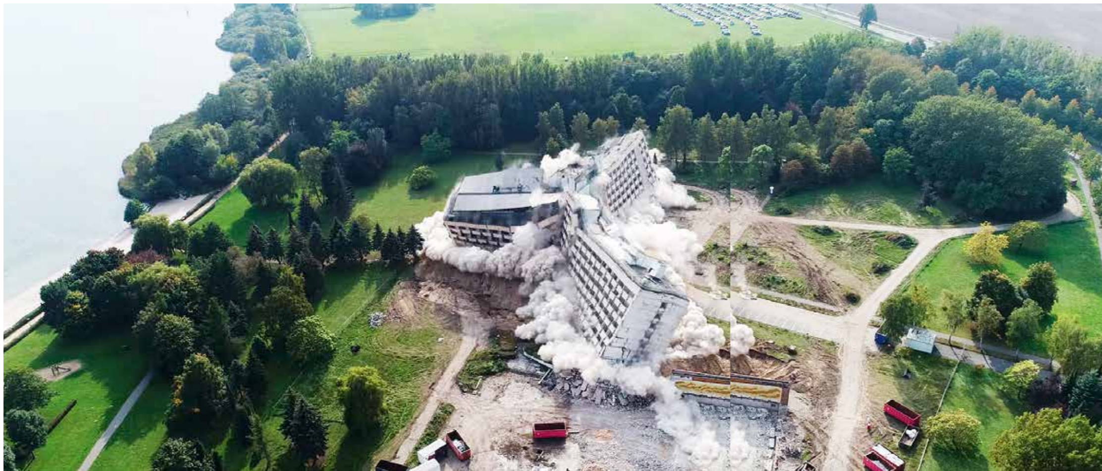
Gekont auf die Seite gelegt: Nach einer vorgegebenen Abfolge brechen die Untergeschosse der drei Flügel des Müritzhotels Ende September in sich zusammen. Übrig bleiben 20.000 Tonnen Bauschutt
