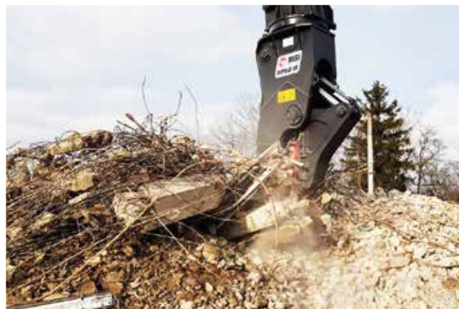
Bei der Zerkleinerung der Betonteile sind die leistungsfähigen Pulverisierer von MBI ideale Partner
