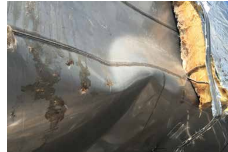
Kaum zu glauben, dass selbst ein Tank, der sich so in Falten gelegt hat, noch zu retten ist
