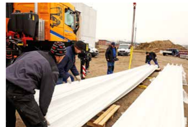
Umständlich, aber unumgänglich: Die Trapezprofile liegen falsch herum auf der Palette und müssen umgedreht werden
