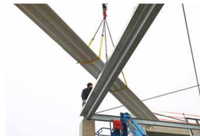
Der Chef des Montagetrupps der Fassadenbauer nimmt auf der Plattform seiner Arbeitsbühne das erste Panel in Empfang
