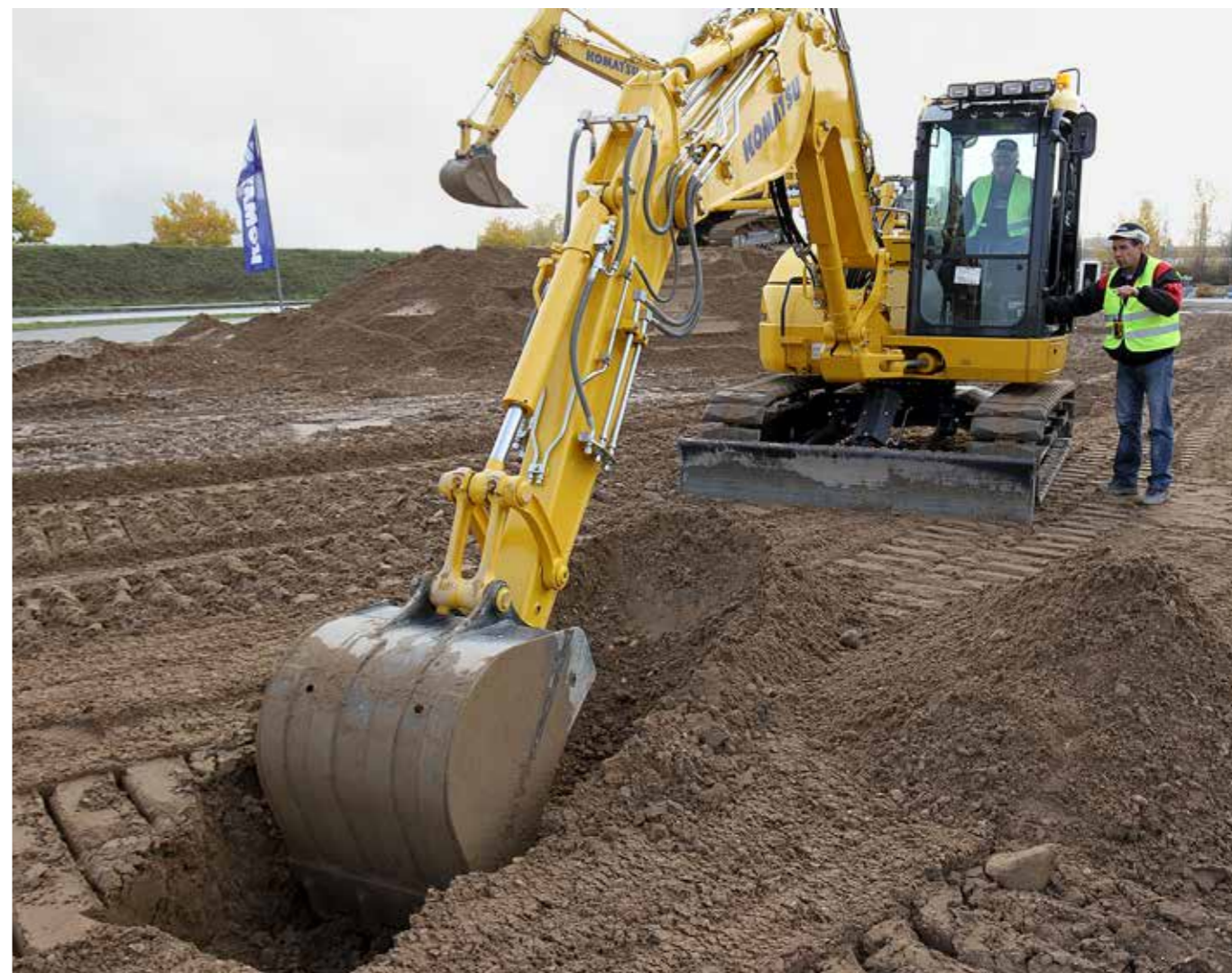
Cihan Altungök entert die Kabine des PC88MR. Erste Aufgabe ist das Ziehen eines Grabens. Den Aushub soll Altungök neben dem Graben ablegen. Geduldig gibt Heiko Boenchen erste Hilfestellungen
